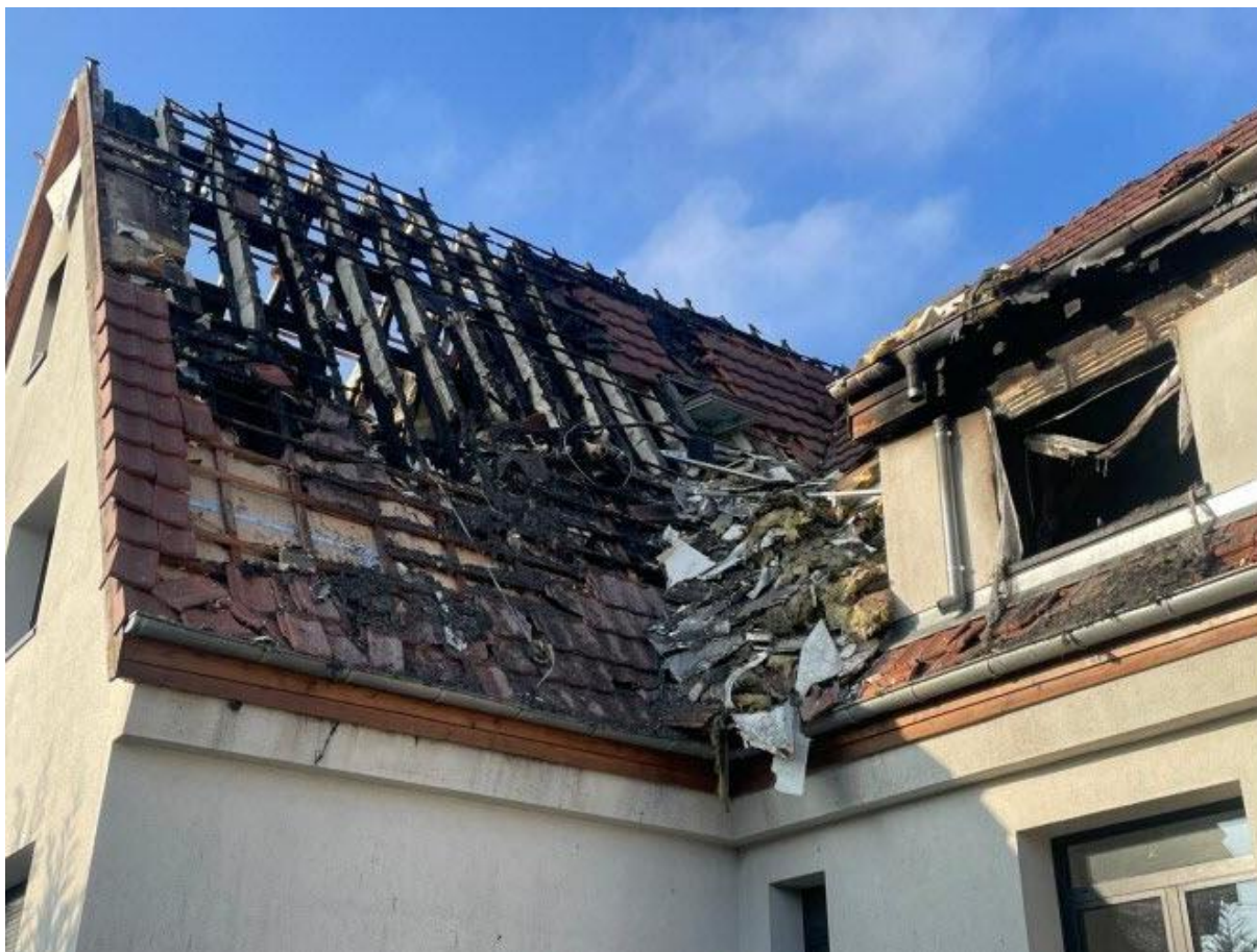
Une grande partie de la toiture est détruite. Photo Jean-Frédéric Surdey
