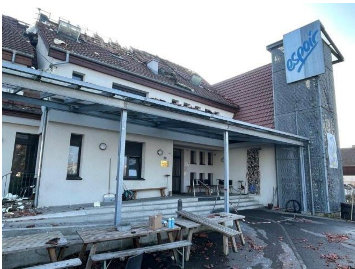
Le foyer Tjibaou, rue de la Fecht à Colmar, après l'incendie, ce samedi 18 janvier. Photo Jean-Frédéric Surdey
